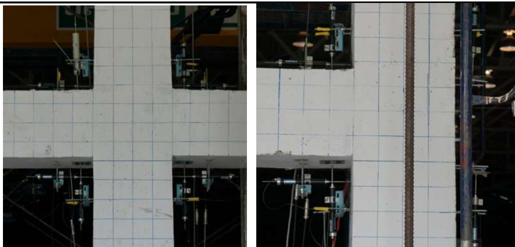
รูปที่ 4-71 ตัวอย่างการติดตั้งเครื่องมือตรวจวัดการเคลื่อนที่บนตอม่อสะพาน
